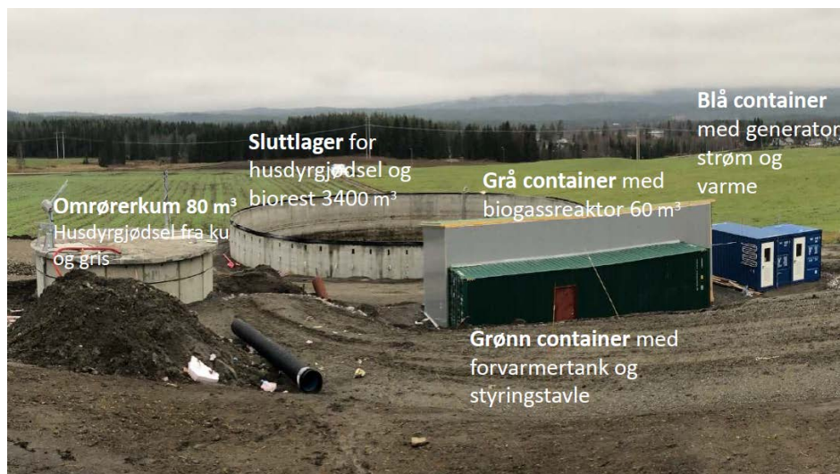
Figur 22. Lokalt behandlingsanlegg for husdyrgjødsel på Presteseter [60]
